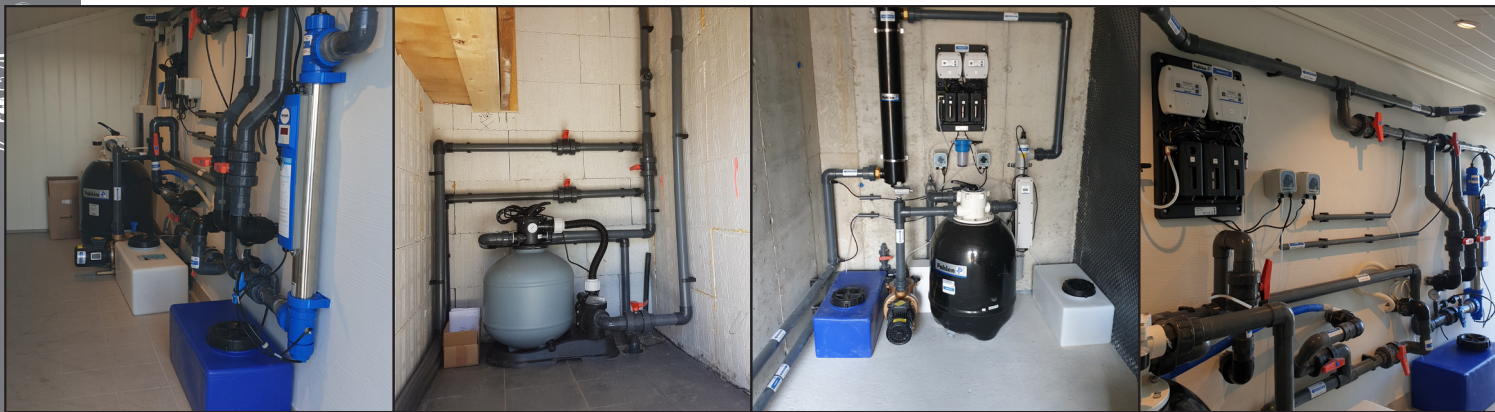
Teknisk rom med sandfiltertank, sirkulasjonspumpe, UV-rensing og Mini Master autodosering. Premium anlegg fra Pahlen.
